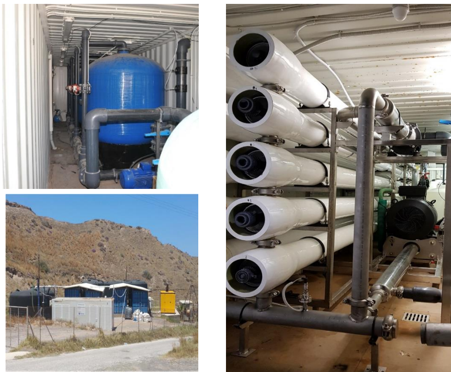
Εικόνα 7: Αφαλάτωση στον Έξω Γιαλό Φηρών (Αρχείο ΔΕΥΑ Θήρας)
