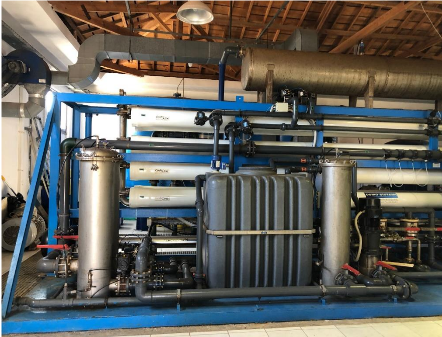
Εικόνα 5: Εσωτερική άποψη της μονάδας αφαλάτωσης των Οινουσσών
