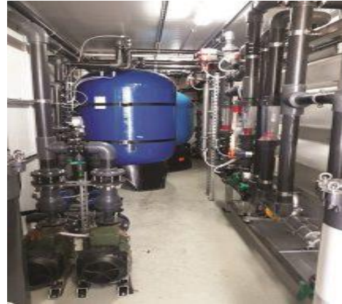
Εικόνα 2: Εσωτερική άποψη της μονάδας
