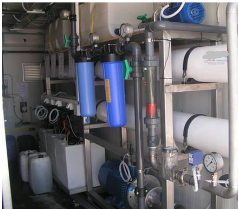
Εικόνα 3: Εσωτερική άποψη της μονάδας Χρυσομηλιάς Φούρνων
